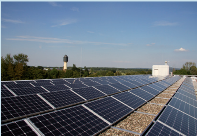
Die Photovoltaikanlage auf dem Dach des Verwaltungsgebäudes des Kraftwerks Staudinger.
